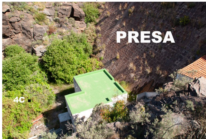
Chira con escombros y vegetación a pie de presa [JG]
